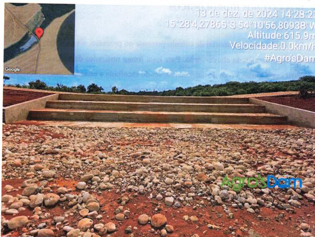
Figura 2 - Dissipador de energia construído na ombreira direita - (imagem fornecida pela responsável técnica Apolina Viera ART 122024028144 “grifo nosso”).
